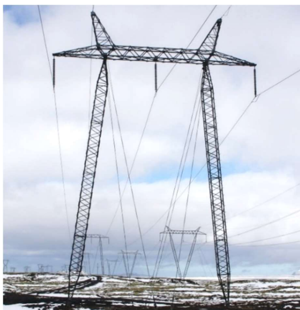
Mynd 4.3 Nýtt burðarmastur með tveimur jarðvírur.
