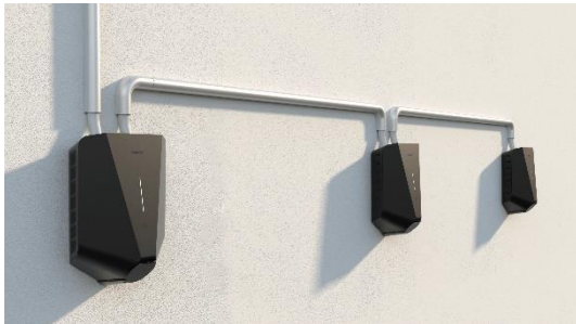
Dæmi um hleðslustöðvar á vegg
