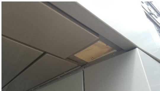
Mynd 29 Undir stélinu er venjulegt gífs klætt neðan á upphengugrind og áklæðning fest neðan á gífsið. Gífsið er mikið myglað. Þar sem útveggir voru mjög loftlekir má gera ráð fyrir að mengun úti geti auðveldlega borist inn í húsið.
