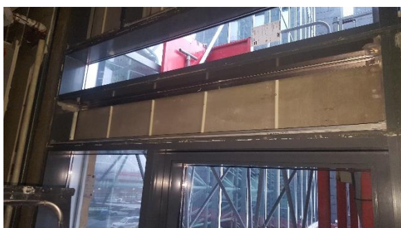
Mynd 5 Viroc plata sem var fjarlægð úr kerfi til rannsóknar séð að innanverðu.
