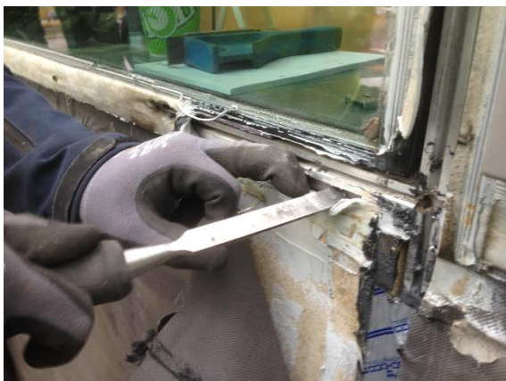
Mynd 11: Á austurhlið er búið er að kitta í gluggaföls með fram VIROC plötum til þess að þetta gluggakerfið en við skoðum kom í ljós bleyta í gluggafalsinu (drenrás) á bak við kítinu og leki innanhúss á sama stað.
