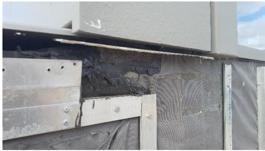
Mynd 27 Dæmi um frágang við svalir (efri enda á útveggjakerfi). Greinilegt er að menn hafa átt í miklum vanda með að fá samsetninguna þetta og er hvert lagið ofan á öðru og samt lak inn.
