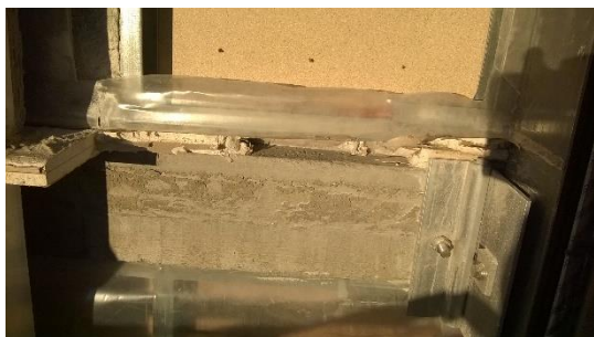
Mynd 25 Tilraun var gerð til að taka brunaloku undan vegg í pörtum og reyndist það frekar auðvelt. Líklega hefði verið hægt að framkvæma verkið að mestu leiti að utan ef ekki hefðu komið til rakaskemmdir í innri klæðningu útveggisins.
