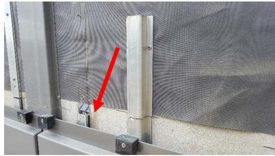
Mynd 28 Dæmi um opin frágang á útvegg. Þéttiband nær ekki niður, það endar á samskeytum pressuplatna. Aukið vatn á greiða leið inn í drenkerfi útveggsins og getur hæglega yfirfyllt það.
