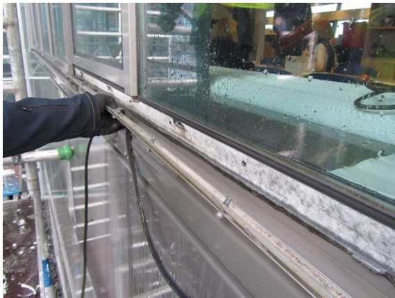
Mynd 15: Á austurhlið 3. hæð norðan við tengibyggingu voru gluggalistar teknir af gleri og gluggakerfi skoðað á móts við lekastaði innanhúss. Þéttiborði er yfir falsi en ekki sjáanlegar drenleiðir.
