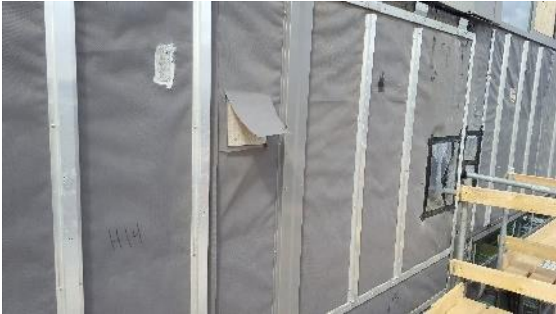
Mynd 4 Öndunardúkur hefur verið settur undir álklaðningu til að þétta útveggi á austurhlið hússins sem er mest áveðurs en á öðrum hliðum er þessi dúkur ekki notaður. Óvíst er hvort dúkurinn hafa skilað tilgangi sínum en augljós ummerki eru um leka inn undir hann undir pressulistum.
