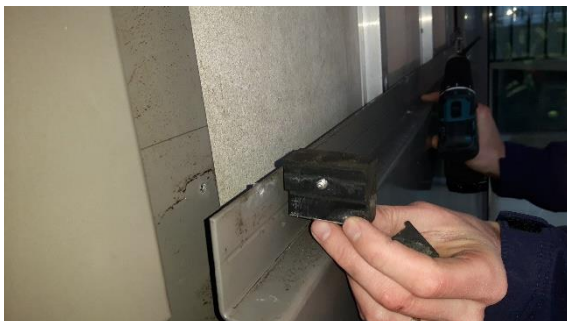
Mynd 29: Festingar á endaleiðurum voru almennt lausar. Skrúfur ná lítið í gegnum leiðara umfram efniþykkt og ekkert hlaup var í álplötu fyrir þenslu.
