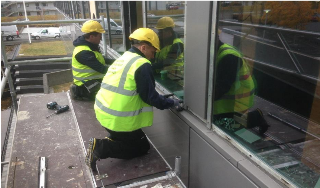
Mynd 5: Útveggir á Vesturhúsi voru opnaðir utanhúss á 2. hæð sunnan við tengibyggingu (glerbygging). Settir voru upp verkþallar og veðurhjúpur hússins skoðaður. Glerlistar voru teknir af gluggum og frágangur þeirra skoðaður auk þess að áklæðning var tekin af til að meta ástand hennar og gluggakerfis undir henni.
