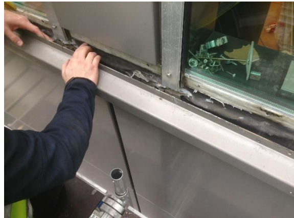
Mynd 8: Undir öllum gluggum (gluggalína) eru vatnsbretti sem eru hluti af álklæðningu hússins. Búið er að endurbæta festingar með utaná liggjandi skrúfum í staðin fyrir upprunalega útfærslu.
