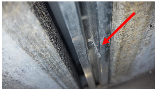
Mynd 36 Boltarás er mjög nöguð í hliðum og gengju festing er léleg. Greinilegt er að skrúfan hefur verið alveg í botni og er myndin þ.a.l. sambærileg tilrauninni á fyrri mynd.
