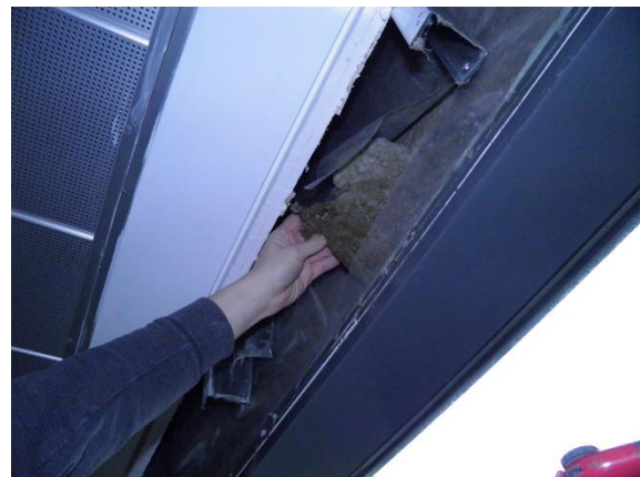
Mynd 18: Lekastaður inni 2. hæð á móts við skoðunarstað utanhúss. Greinilegur leki er á bak við einangrun í gluggakerfi sem má að öllum líkindum rekja til of stuttra VIROC platna og mikils vatns í falsi.
