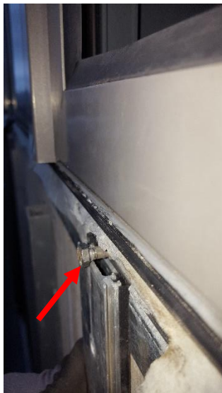
Mynd 35 Gerð var tilraun til að skoða hversu mikla eiginlega pressu þéttingar í kerfinu eru að fá. Skrúfan er skrúfuð í botn í festirauð og pressuplata borin við án þess að þrýsta henni að útvegg. Greinilegt bil er milli skrúfuhous og pressuplöt. Lítil sem engin pressa er þ.a.l. til staðar.
