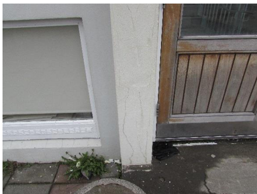
Mynd 2.9 Mikið sprunginn veggendi
