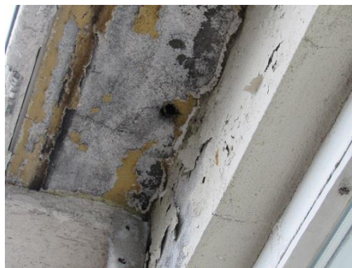
Mynd 2.30 Frostskegmdir undir múrklæðningunni.
