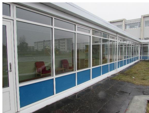
Mynd 3.2 Nýlegir gluggar vestari tengibygging
