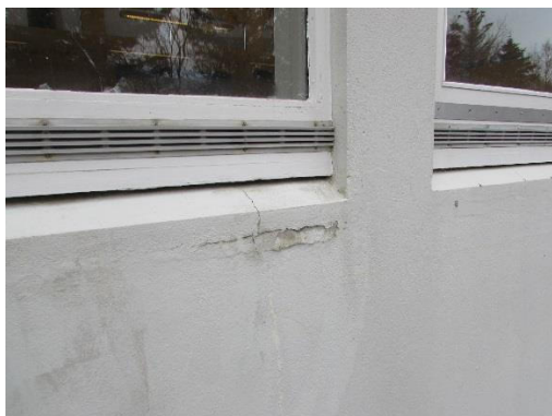
Mynd 2.15 Laust vatnsbretti og kalkútfelling
