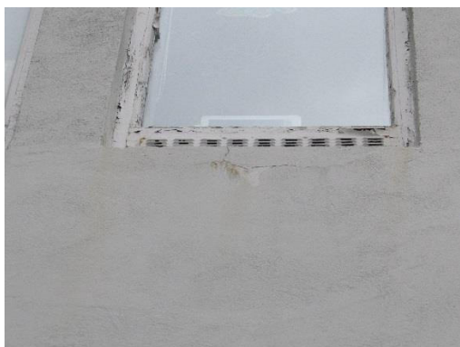
Mynd 3.5 Skemmdur og flagnaður gluggi
