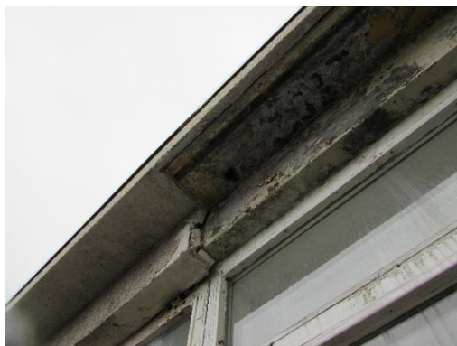
Mynd 2.29 Skemmdir í þakkantinum
