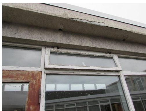
Mynd 3.8 Illa farið opnanlegt fag
