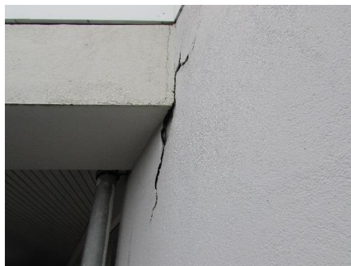
Mynd 2.34 Biti, ljót sprunga við útvegg.
