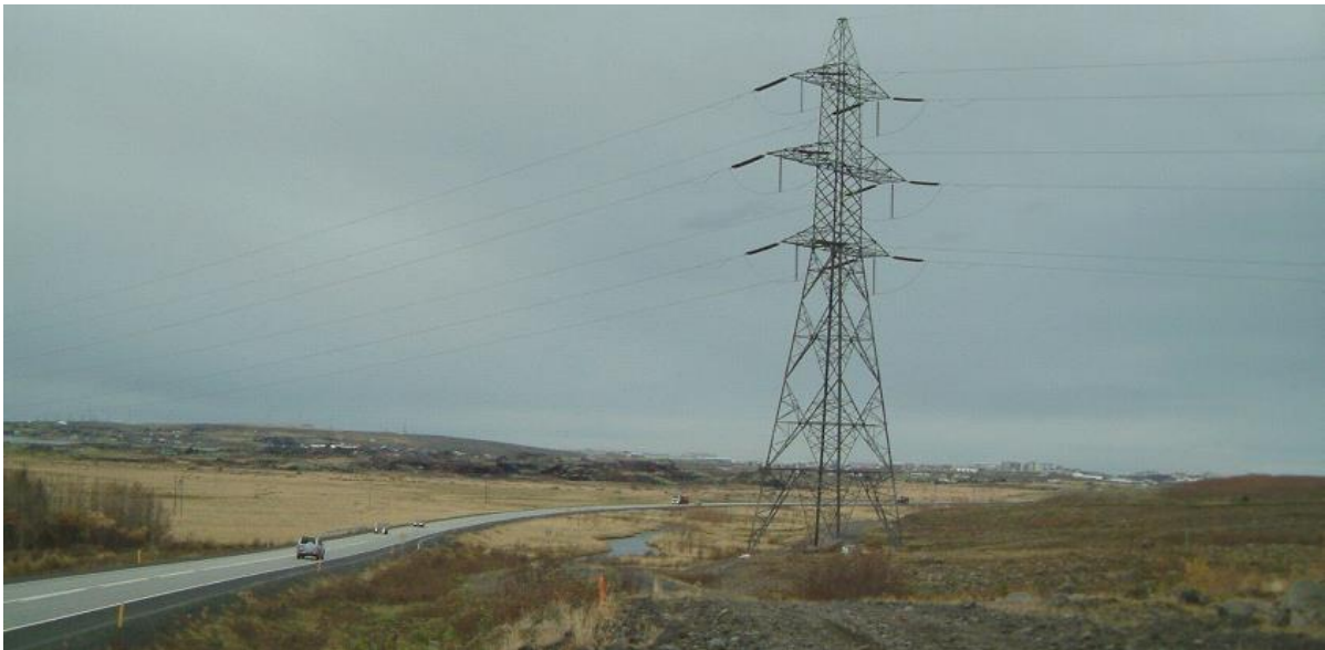
MYND 2.23 Hamraneslínur 1 og 2 (220 kV) þvera Suðurlandsveg í stöð 6420.
