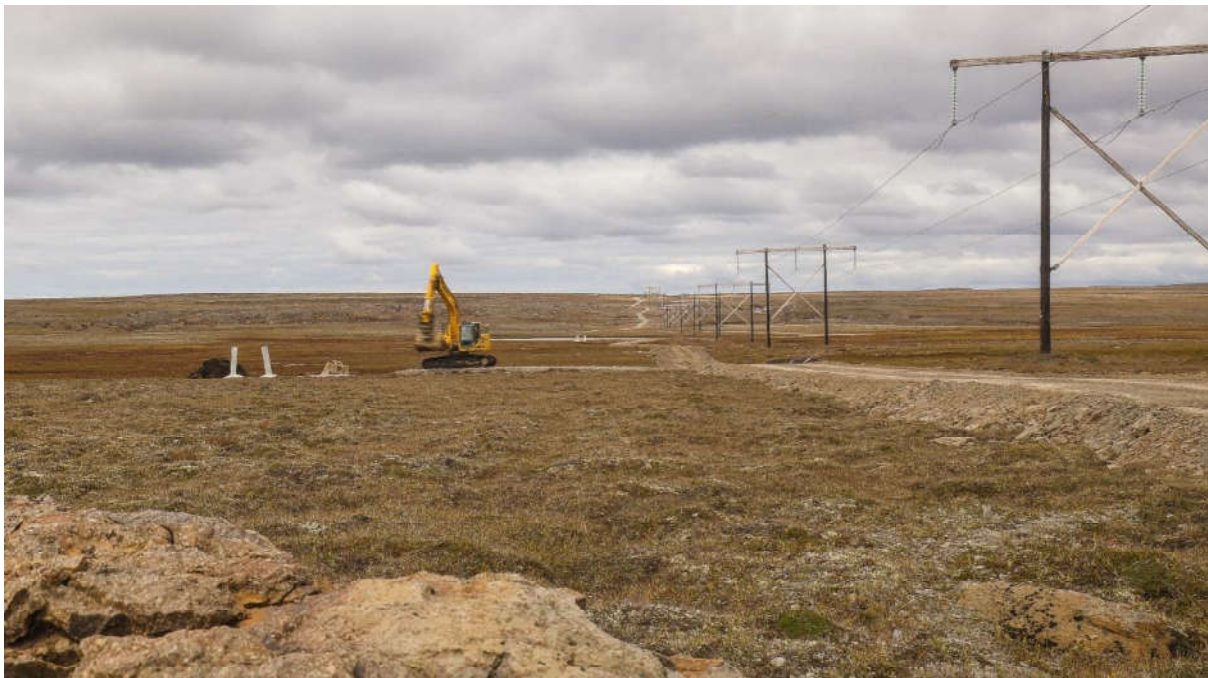
Mynd 6.7. Slóðagerð við Kröflulínu 3. Á myndinni sést núverandi 132 kV loftlína þar sem lögð hefur verið slóð samsíða og undirbúin mastraplön fyrir nýja 220 kV Kröflulínu 3.
