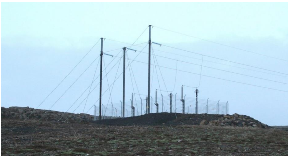
Mynd 6.9. Endavirki fyrir 132 kV jarðstreng (eitt strengjasett) í Hnoðraholtslínu 1. Efst eru jarðvívar til að verjast eldingum. Endavirkin í Lyklafellslínu 1 þyrftu að vera talsvert umfangsmeiri, þar sem um er að ræða 220 kV jarðstreng.
