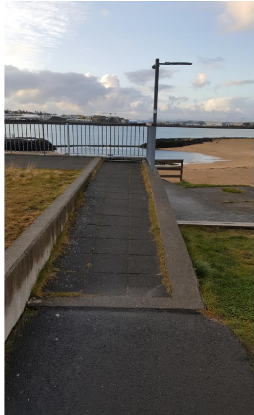
Mynd 2.13: Skábraut að vestanverðu að þaksvæði- halli of mikill og 10 cm stallur efst.
