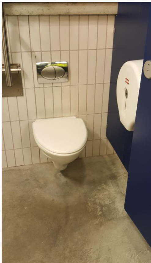
Mynd 3.5: Óhentug staðsetning salernisskálar, ein armstoð
