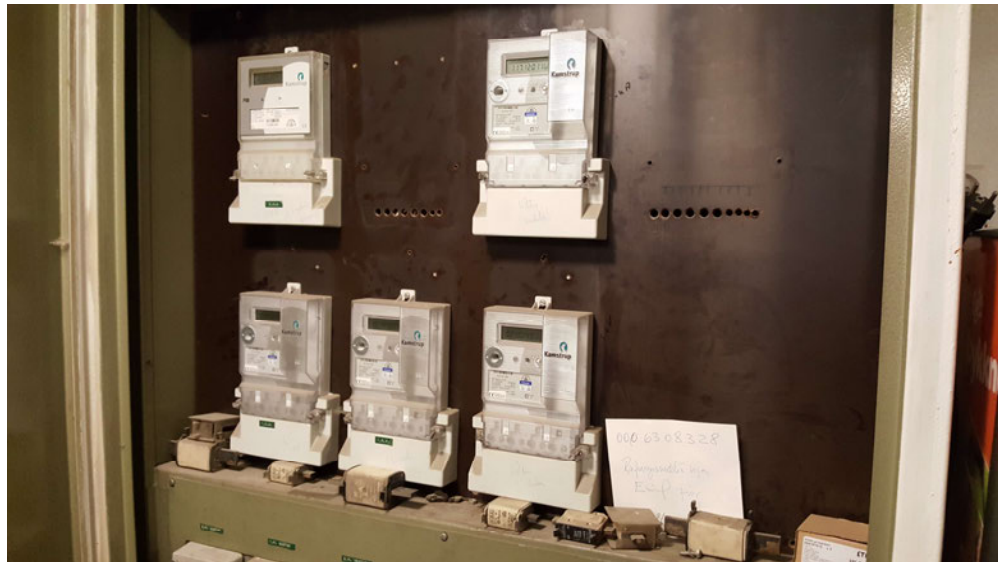
Mynd 2.1. Aðalrafmagnstafla byggingar.
