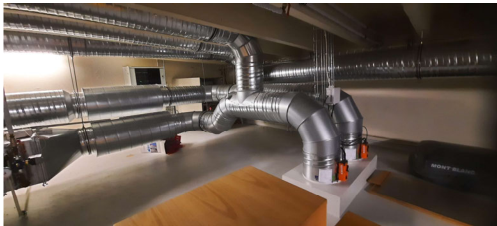
Mynd 2.3. Loftræstilagnir á geymslulofti.
