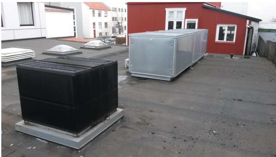
Mynd af óleyfisframkvæmdum teknar af starfsmönnum skilmálaeftirlits á skrifstofu byggingarfulltrúa vorið 2017.
