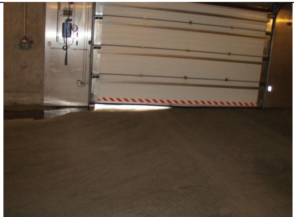
Mynd nr. 2. Stór rífa er undir innkeyrsluhurð 2. hæðar og þar flæðir vatnið inn. Steypa þarf hrygg í gatið til að stoppa vatnsflóðið. (1)
