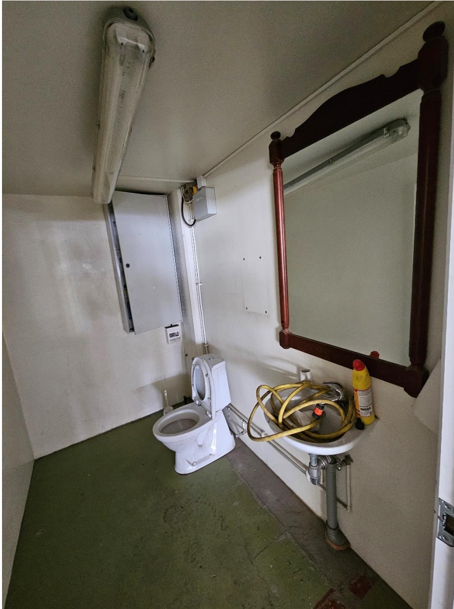
MYND 21 Klósett, vaskur, spegill og rafmagnstöfluskápur.
