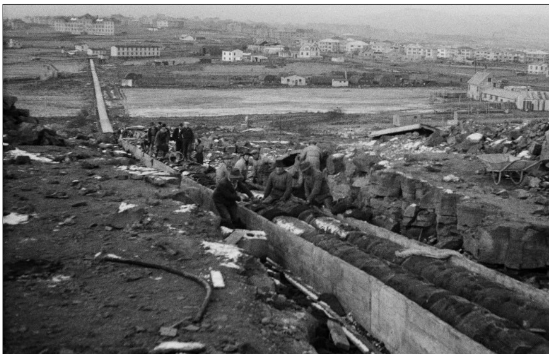
Mynd 16. Ljósmynd frá því um 1942 sem sýnir verkamenn einangra hitaveiturör í hitaveitustokk með torfi norðan í Öskjuhlíð. Í baksýn sjást Hlíðarnar, Pólarinn og Landspítalinn. 52
