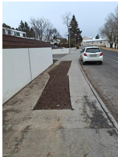
Mynd 4.18 Löng hola í gangstétt sem ekki er varað við. Við Sunnuveg 27.
