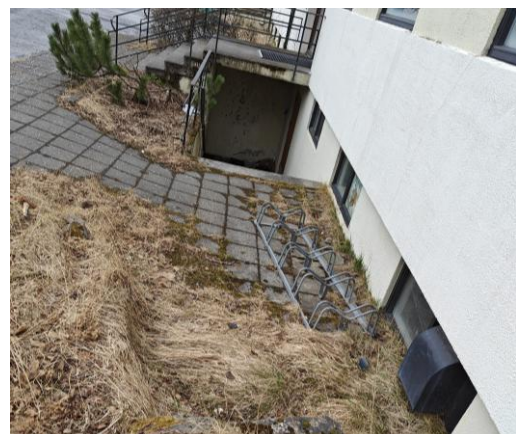
Mynd 4.24 Hjólastæði sem eru við inngang við Dyngjuveg. Fjarlægja þarf gróður við hjólastæðið, festa það niður og staðsetja það betur fjær tröppunum niður í kjallara. Hjólastæði þetta uppfyllir fáar kröfur sem gerðar eru til hjólastæða í hönnunarleiðbeiningum fyrir hjólreiðar.
