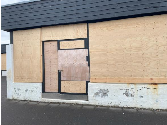
Mynd 5-23: Málning farin að flagna og ryðpunktar sjáanlegir undir glugga.
