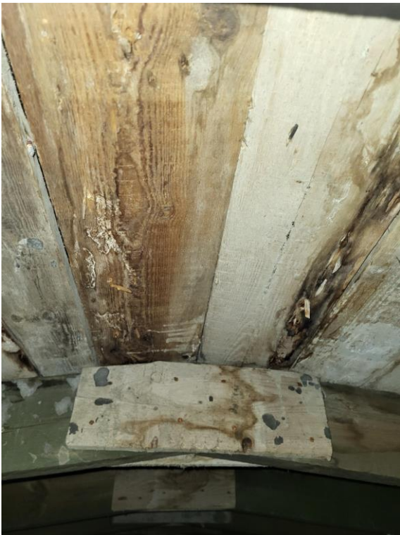
Mynd 5-25: Borðaklæðning í álmu b. Greinilegt að það lekur inn í þakið og mygla sjáanleg á borðaklæðningu.
