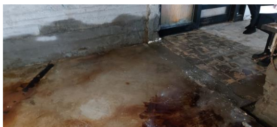
Mynd 5-12: Leki í gegnum þakplötu.
