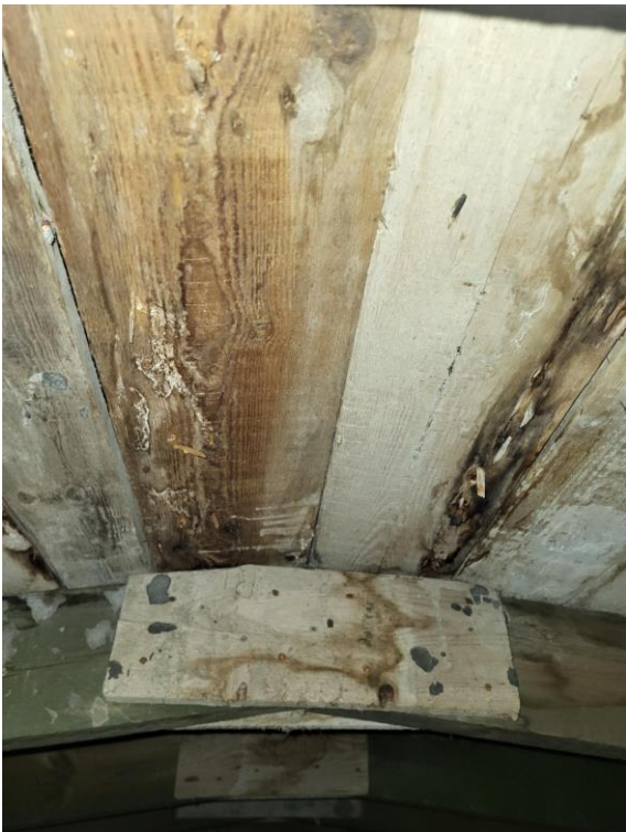
Mynd 5-25: Borðaklæðning í álmum b. Greinilegt að það lekur inn í þakið og mygla sjáanleg á borðaklæðningu.
