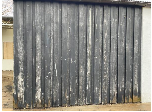
Mynd 5-2: Timburklæðning farin að fúna við pall.
