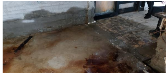
Mynd 5-12: Leki í gegnum þakplötu.
