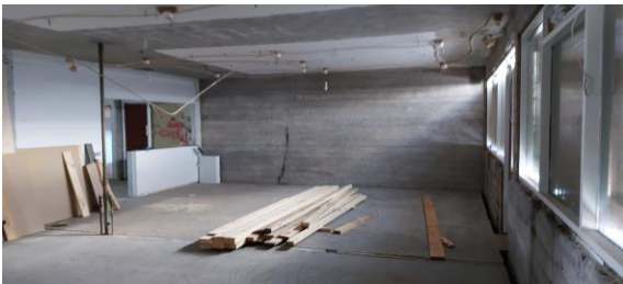
Mynd 5-9: Álma a, búið að hreinsa út úr húsinu.
