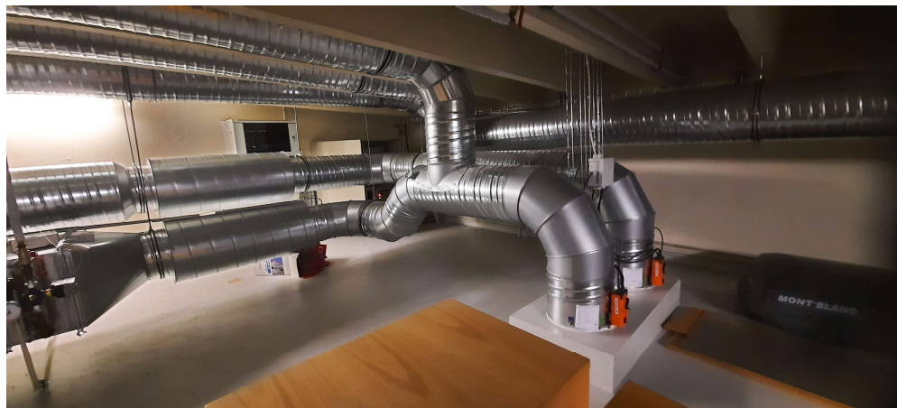
Mynd 2.3. Loftræstilagnir á geymslulofti.
