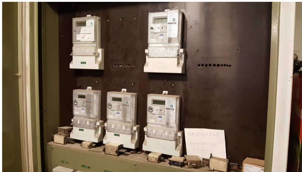
Mynd 2.1. Aðalrafmagnstafla byggingar.
