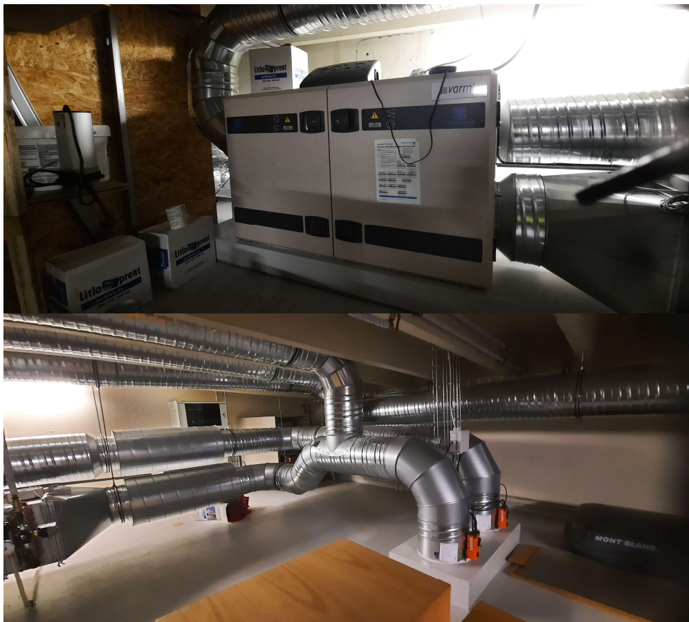
Mynd 6.16. Loftæstisamstæða og loftæstilagnir.
