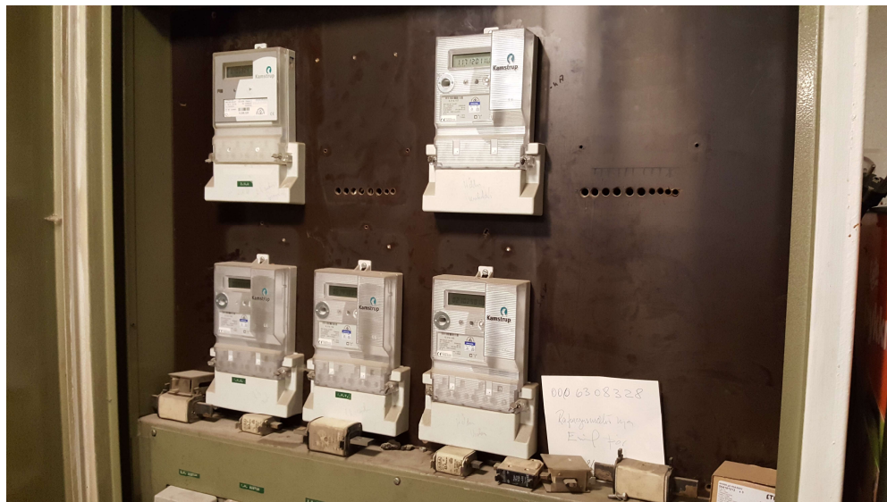
Mynd 2.1. Aðalrafmagnstafla byggingar.
