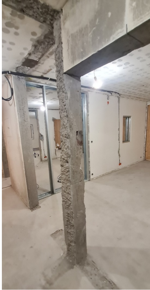
Mynd 2.8 - Súla sem stendur ein eftir að innveggir í kring hafa verið fjarlægðir. Súlan er 200x200mm og þversnið hennar er rýrt af rafmagnsdós. Súlan sem eftir stendur er ekki með fullnægjandi járnbindingu.
