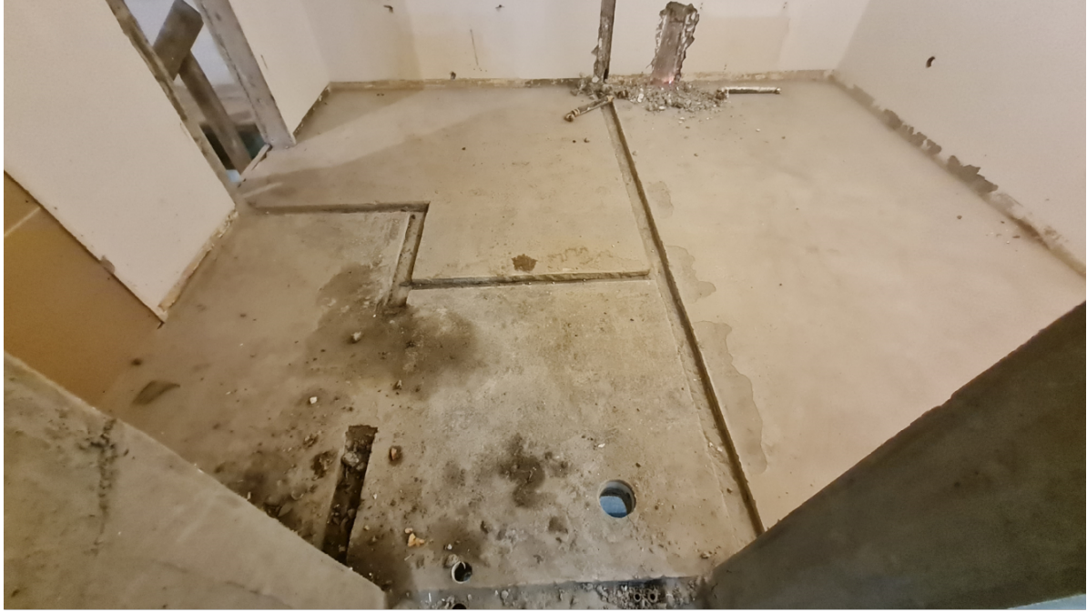
Mynd 2.13 – Hér má sjá hvernig illögn hefur verið sett upp að léttum innveggjum sem hafa verið fjarlægðir.
