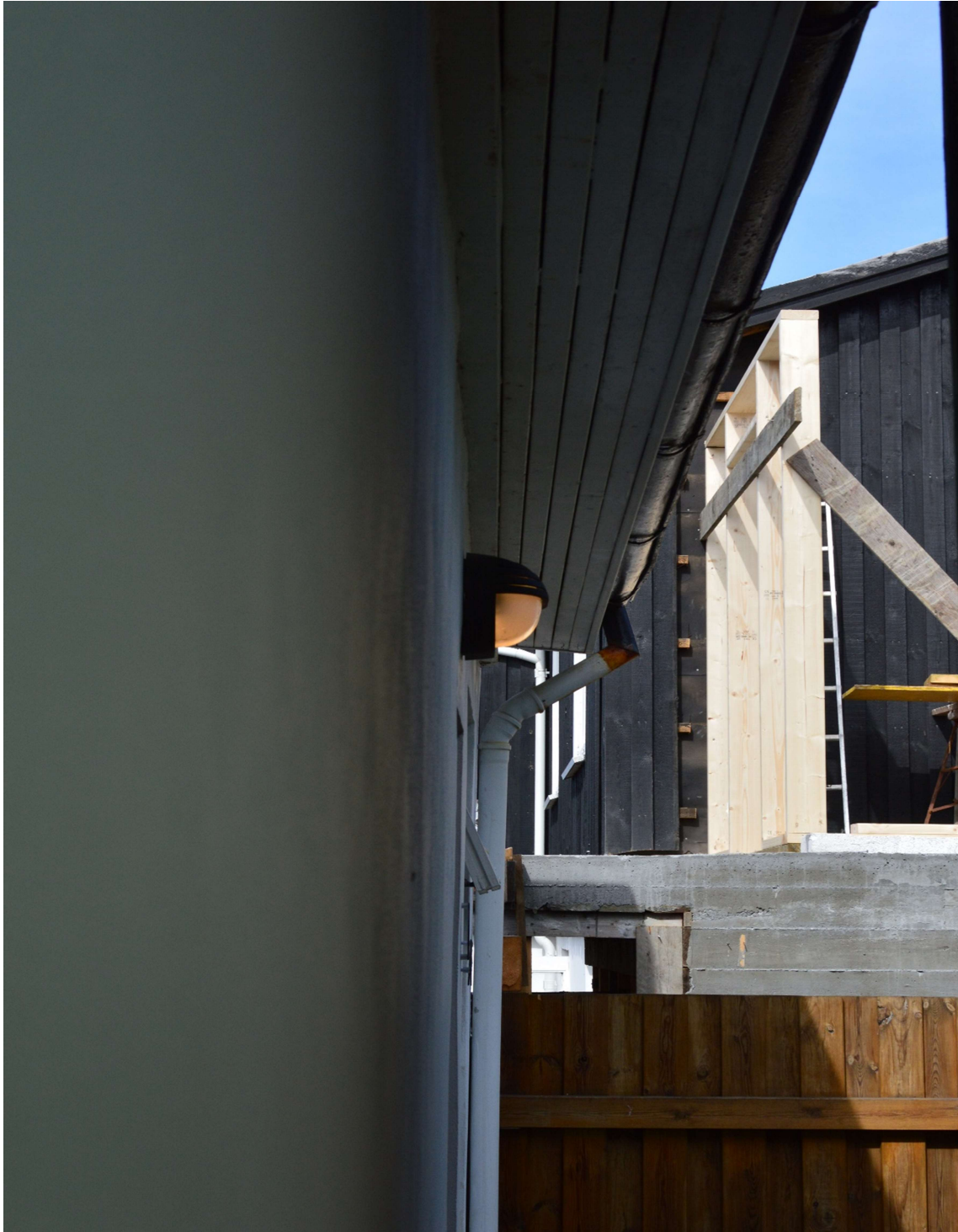
Mynd 2 Sýnir nálægð við nr. 6A, og sambrunahættu við 6A. Öll efri hæð nr. 4 er eitt brunahólf með mjög lítið brunapól (í gamla hlutanum er viðarklæðning að innan, sag í veggjum, og viðarklæðning að utan). Sýnir líka hversu lítil fjarlægðin er í viðbyggingu frá nr. 6A og steiptar svalir sem skaga út í átt að húsinu nr. 6A (þessar svalir eru ekki sýndar á samþykktri teikningu, sjá mynd 8)
