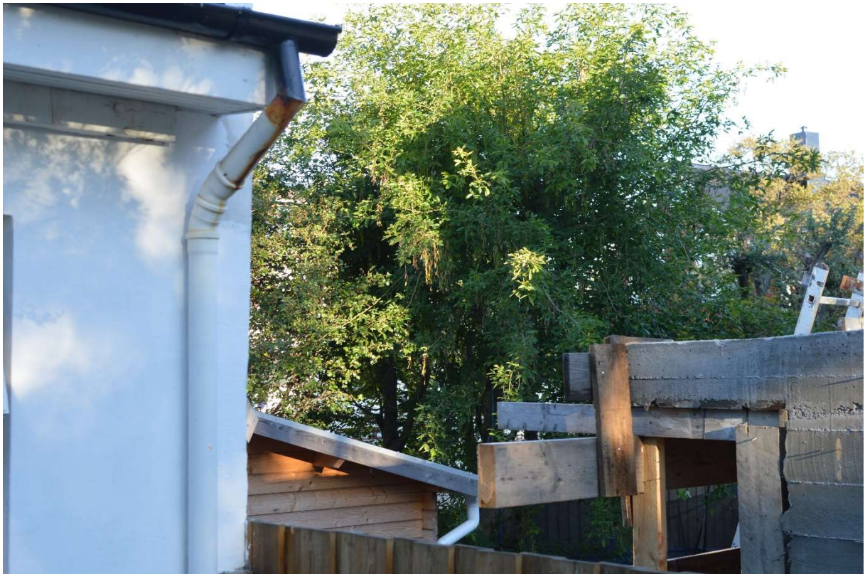
Mynd 1 Viðbygging er of nálægt 6A og skúr veldur mikilli sambrunahættu á lóðunum (girðing er ekki á lóðarmörkum sem eru 40 cm lengra inn á lóð nr. 4)
