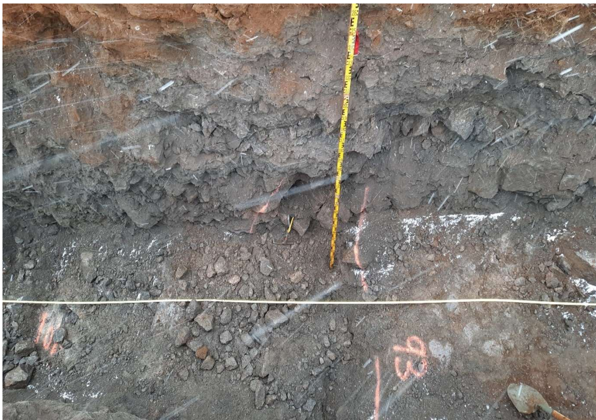
Mynd 20. Skurður 3, vinstri veggur og botn. Virk sprunga í stöð 93.
