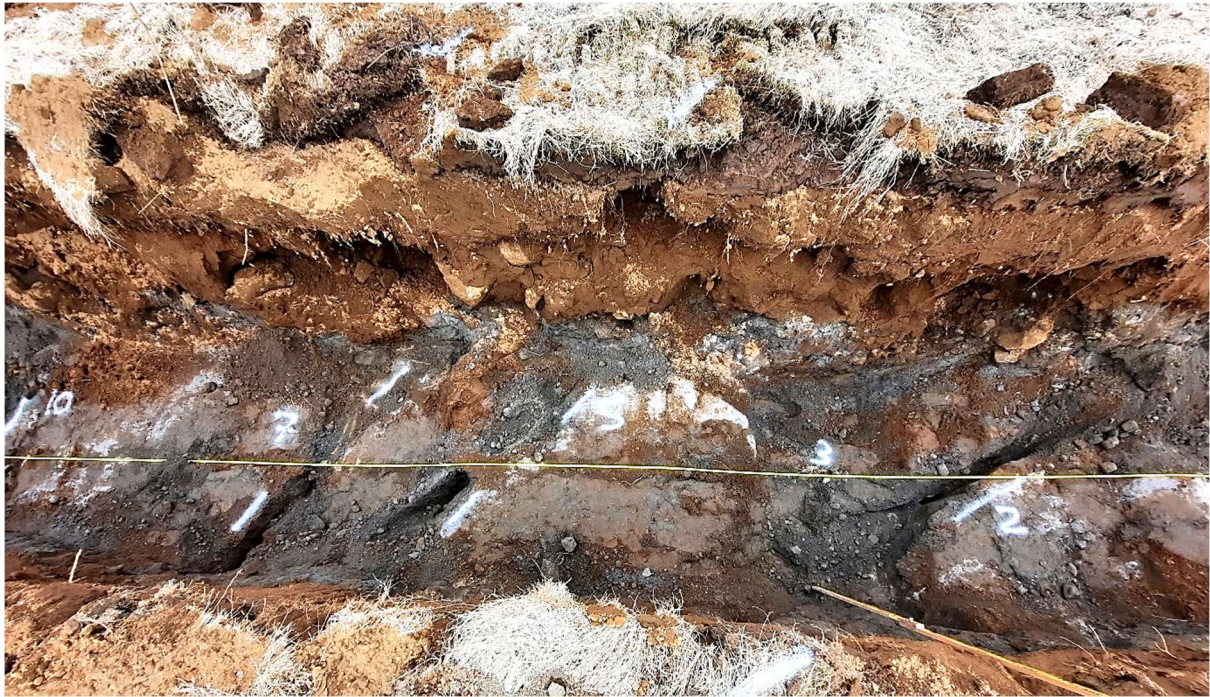
Mynd 6. Horft yfir SA-enda skurðar 4b þar sem þrjár greinilegar sprungur fundust (stöð 3, 5 og 7).
