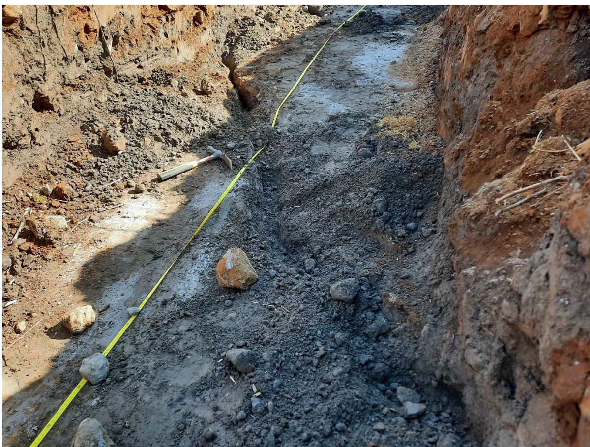
Mynd 38. Skurður 5. Horft eftir sprungunni í stöð 92.
