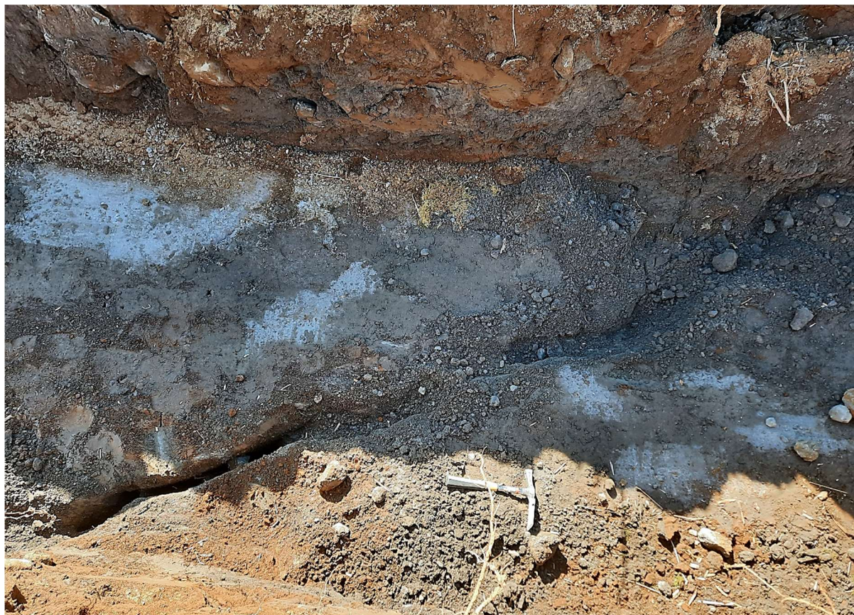
Mynd 7. Horft ofan á sprunguna í stöð 92.
