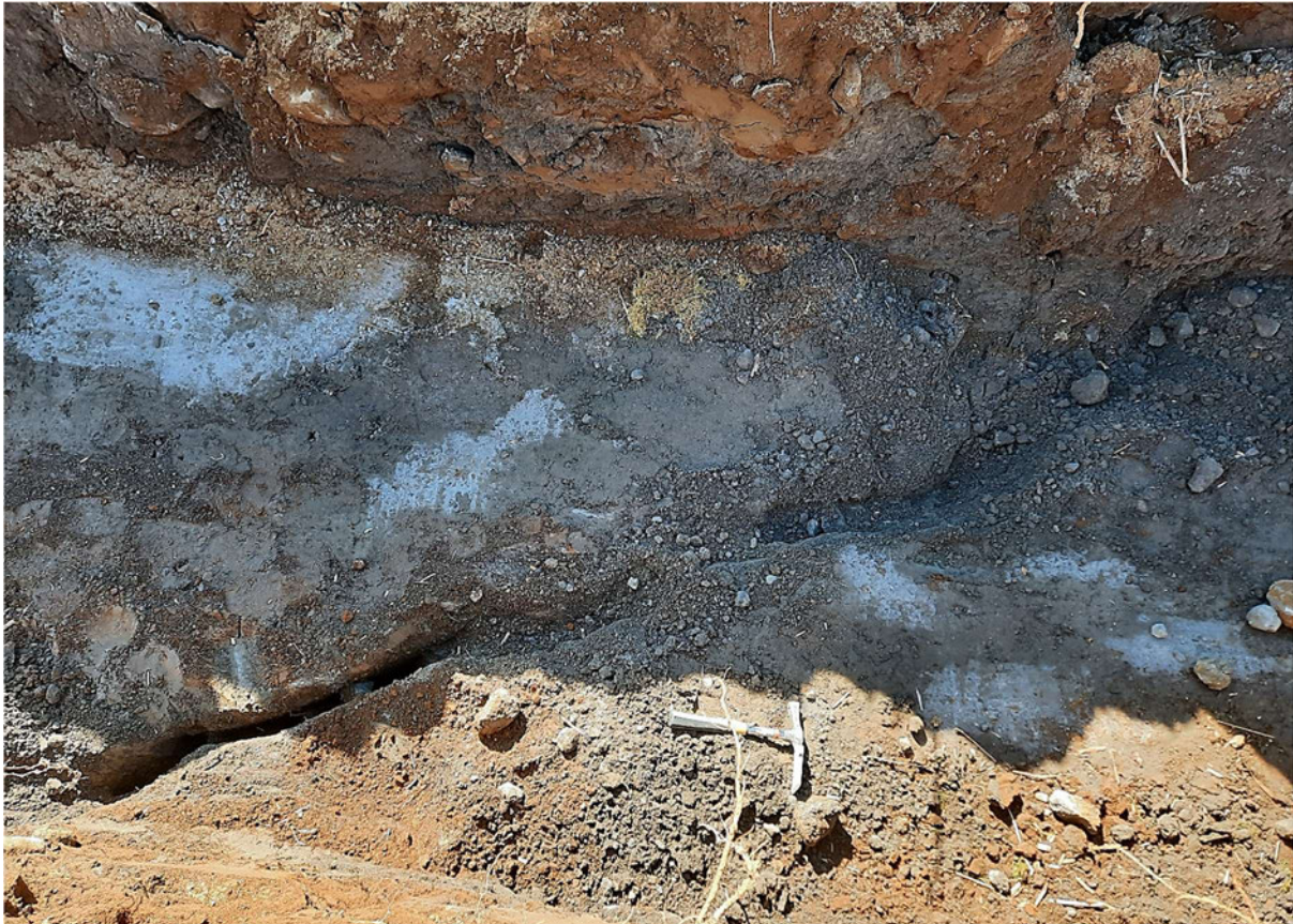
Mynd 7. Horft ofan á sprunguna í stöð 92.
