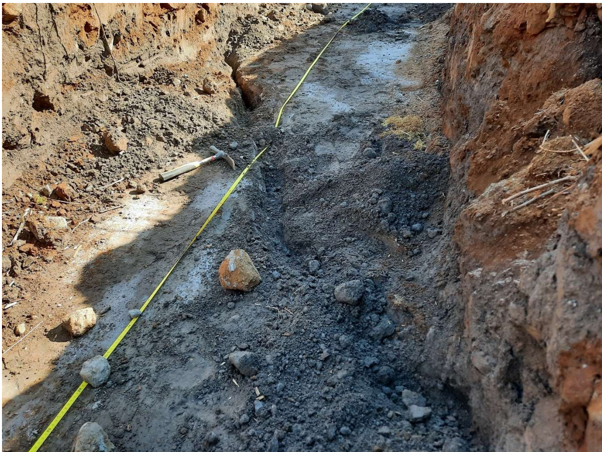
Mynd 38. Skurður 5. Horft eftir sprungunni í stöð 92.
