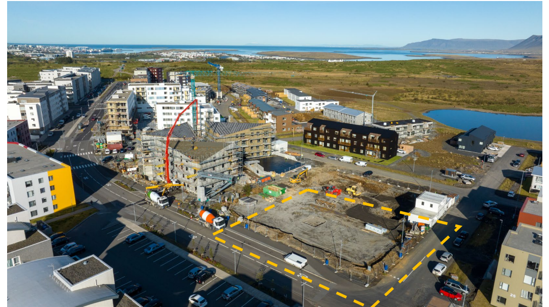
Haustið 2023 var jarðvinna hafin vegna fyrstu 36 leiguíbúða Blævar við Skyggnisbraut 21-23 í Úlfarsárdal. Verklok eru áætluð um áramót 2024-25.
