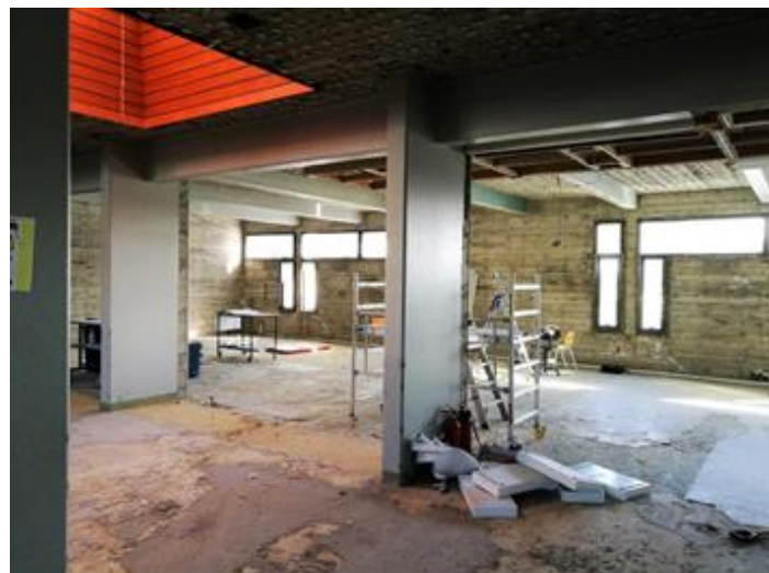
Nauðsynlegt reyndist að fjarlægja alla klæðningu af útveggjum suðurálmú í eldra húsnæði. Lekið hafði með gluggum og klæðning skemmst. Maí 2018.
