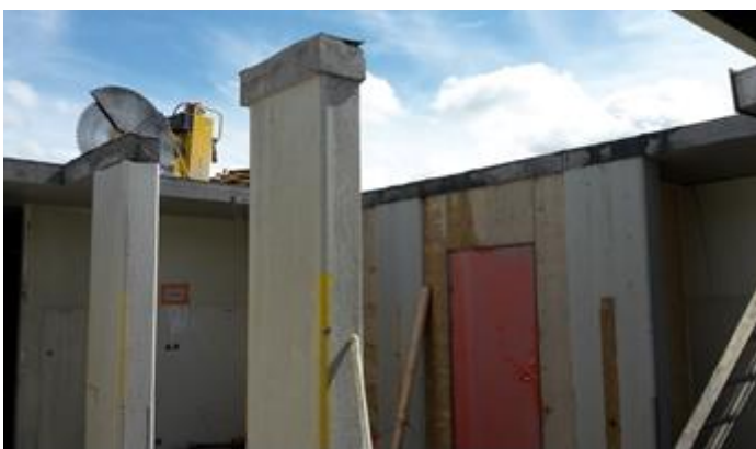
Júlí 2016. Tenging viðbyggingar við eldra hús var umfangsmikið og vandasamt verk. Það þurfti að vinna í sumarfrí skólans og vera tilbúið í skólabyrjun.
