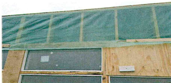
MYND 10 Timburveggur á austurhlið 4.hæðar. Uppbyggingin er að mati EFLU áhættusöm m.t.t. þéttingar.
