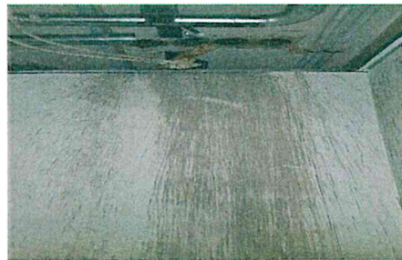
MYND 11 Búið að kjarnabora fyrir lagnaleiðum í geymslu á 2.hæð. Engar varnir og frágangur hefur blotnað.
