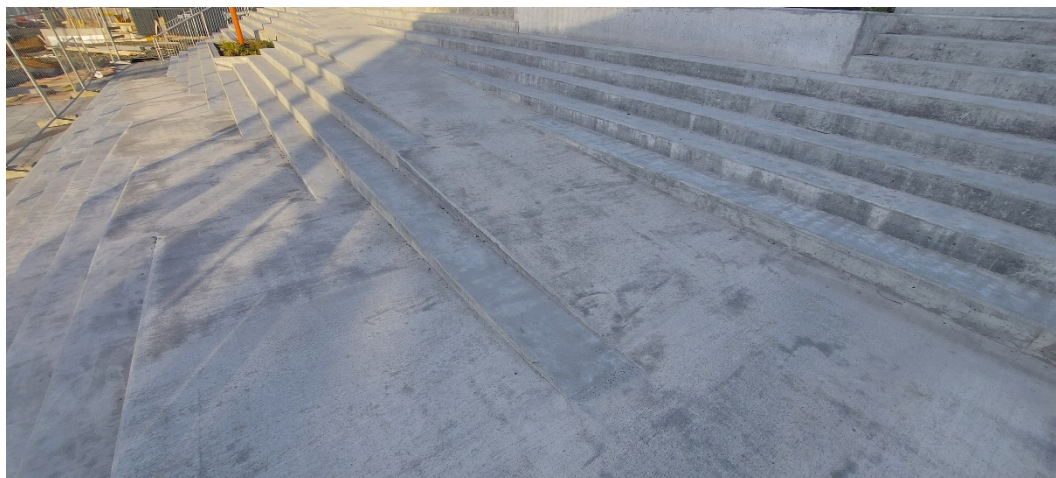
Mynd 7.3-4 Mörk þrepa og ramps er ekki greinilegur og stórhættulegur.
