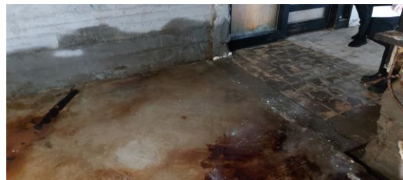
Mynd 5-12: Leki í gegnum þakplötu.
