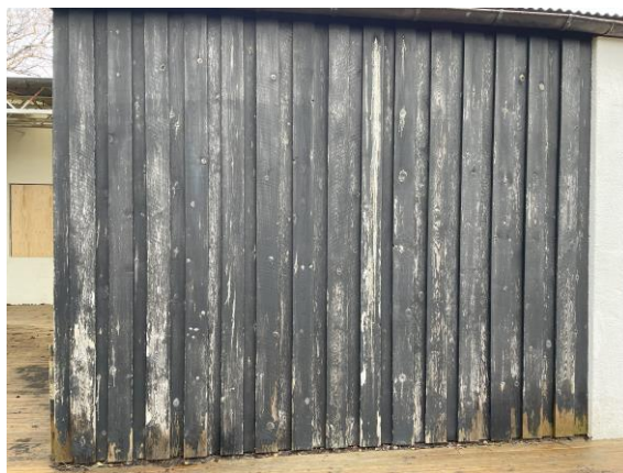
Mynd 5-2: Timburklæðning farin að fúna við pall.
