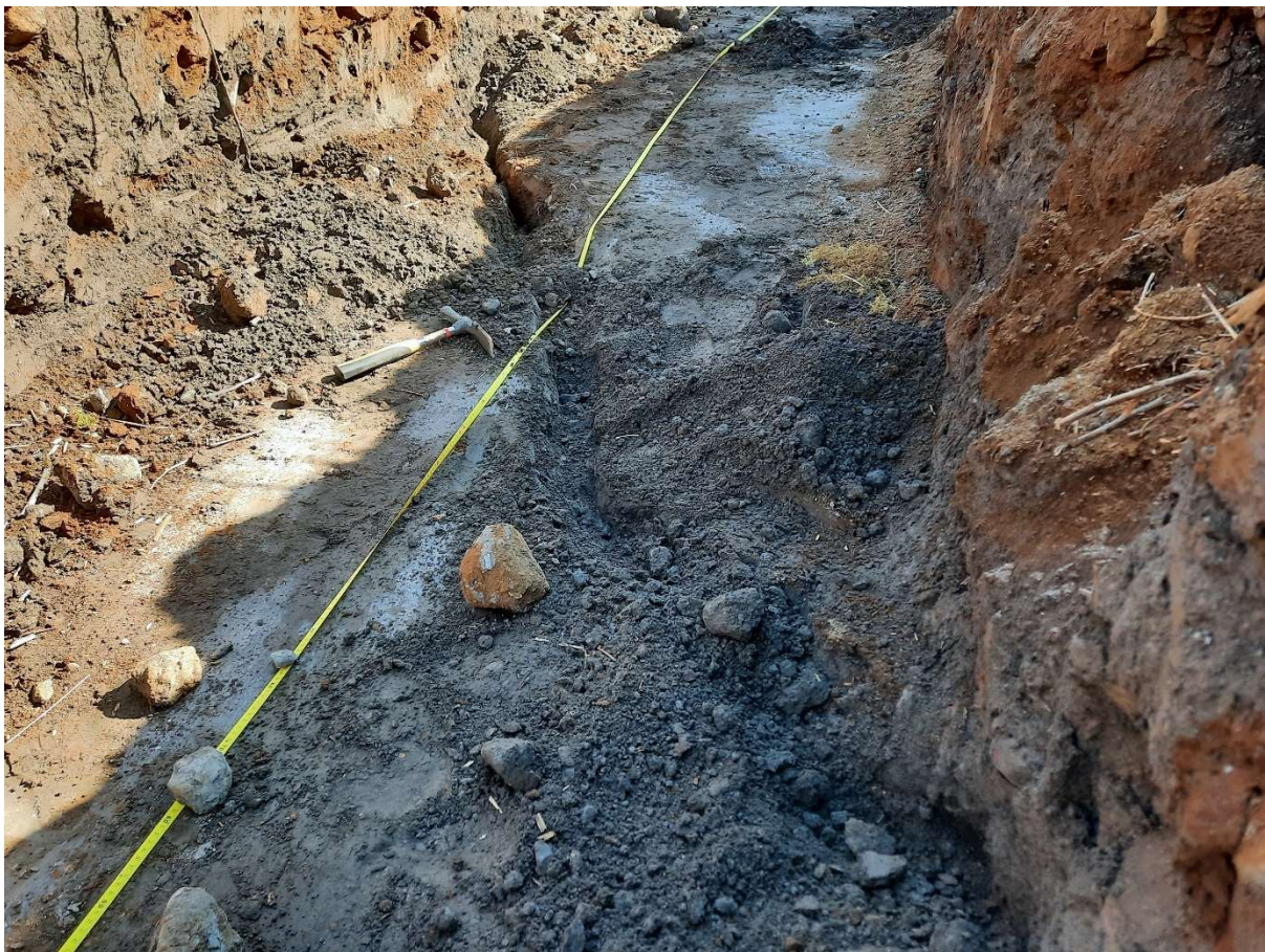
Mynd 38. Skurður 5. Horft eftir sprungunni í stöð 92.
