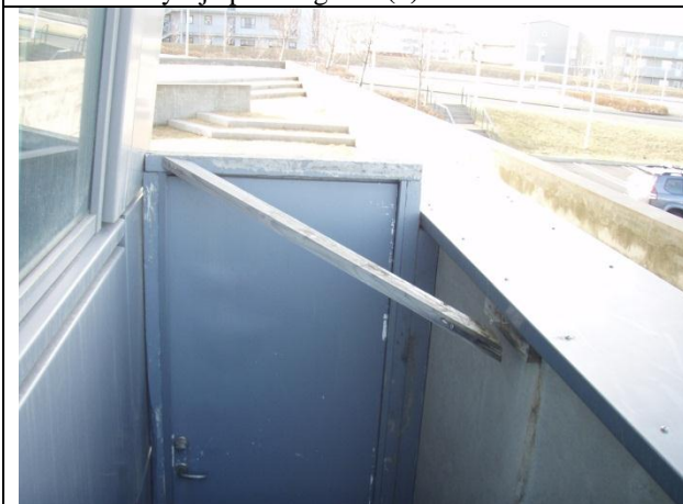
Mynd nr. 3. Bráðabirgða timburhurð sem sett var fyrir stiga upp á þak utan við 1. hæð að vestan er laus. Laski hefur rífið sig lausan. Setja þarf varanlega hurð hér. (1)
