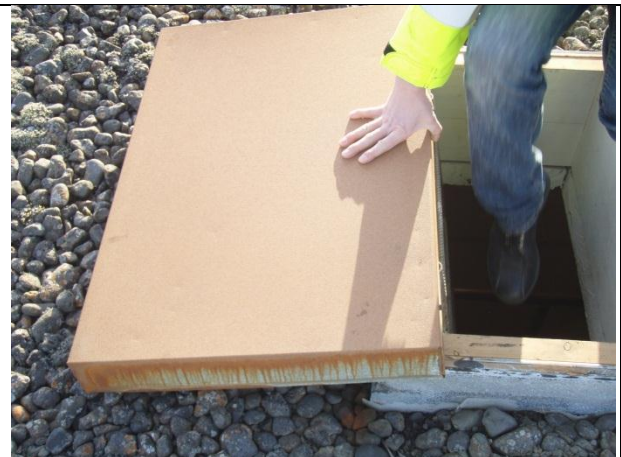
Mynd nr. 2. Blikklok á mannopi upp á þak er ryðgað og þarf að mála það. (2) Einnig er lokið laust að sunnanverðu frá krossviðarplötunni undir henni. Festa þarf blikklokina sem fyrst til að það fjúki ekki af. (1)
