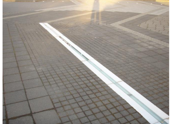
Mynd nr. 2. Víða eru brotin þykk gler í niðurfelldum ljósarennunum í göngustíg milli hleðsluveggja við bílaplan og fossum. Gera þarf við þessar ljósarennur. (1)
