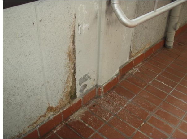
Mynd nr. 4. Lekaskemmdir eru á vegg milli efri og neðri gólfplötu. Setja þarf upp dælubrunn til að lækka vatnsstöðuna. (2)
