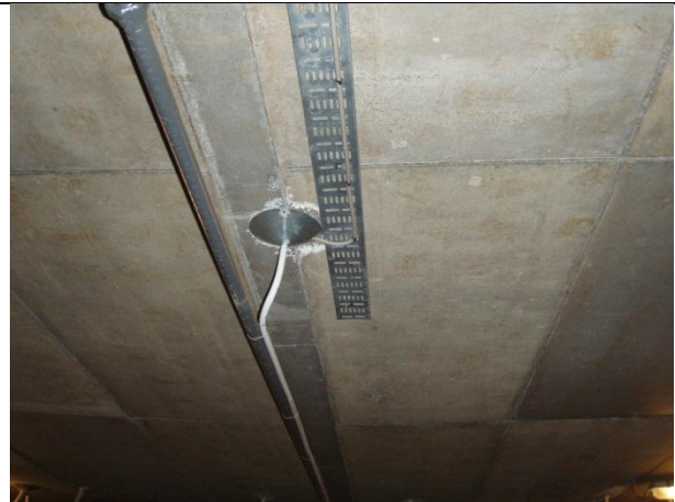
Mynd nr. 6. Trektir hafa verið settar neðan við lekastaði á þaki bílgeymslu og eru rör frá þeim allt of grönn. Stækka þarf rörin til að þau stíflist ekki. (2)
