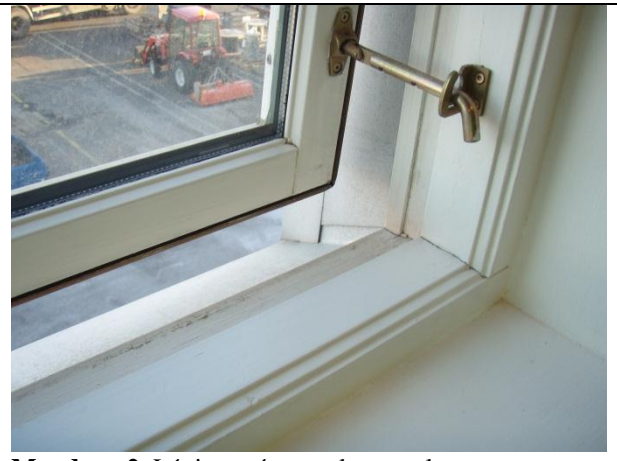
Mynd nr. 2. Þéttingar á opnanlegum gluggum eru óþéttar. Yfirfara þarf þessar þéttingar til að ekki blási inn með gluggunum. (2)
