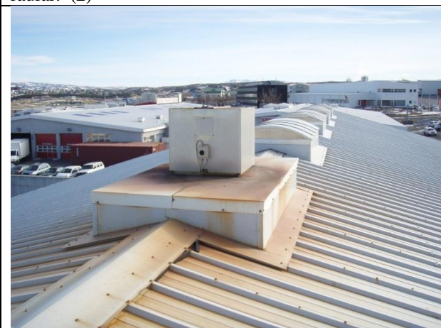
Mynd nr. 3. Ryð er komið í langsamskeyti, skrúfur og víða á þaki Norðurhús. Mála þarf þakið innan 2-3 ára. (2)
