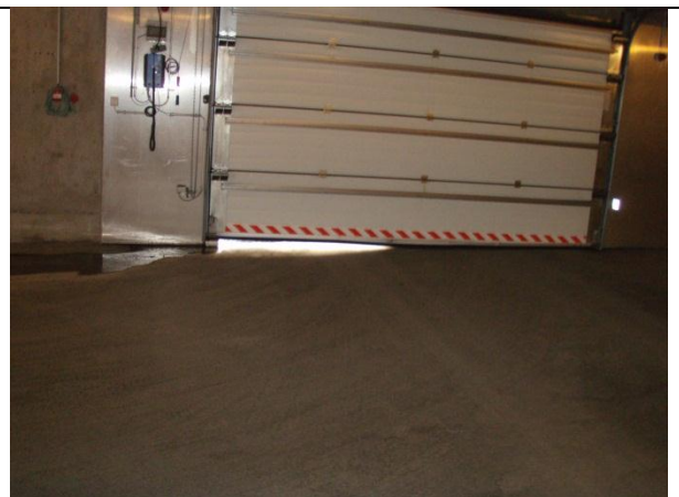
Mynd nr. 2. Stór rifa er undir innkeyrsluhurð 2. hæðar og þar flæðir vatnið inn. Steypa þarf hrygg í gatið til að stoppa vatnsflæðið. (1)
