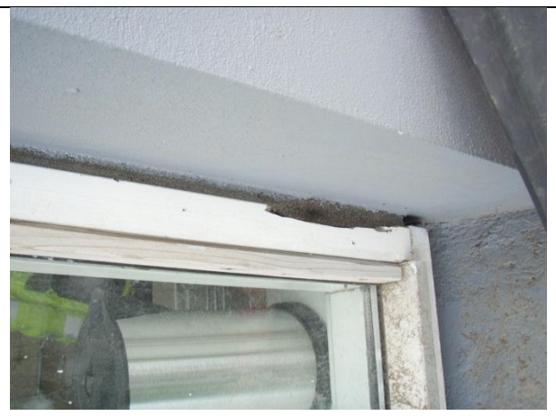
Mynd nr. 4. Þéttingar vantar í kringum hurðir og glugga sem eru í steyptum útveggjum á jarðhæð hússins. Yfirfara þarf þessar þéttingar. (2)
