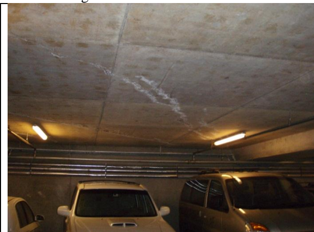
Mynd nr. 1. Margar sprungur eru í millilofti bílageymslu og þar kemst vatn greiðlega í gegn. Þetta þarf þessar sprungur og veita vatni burt. (1)
