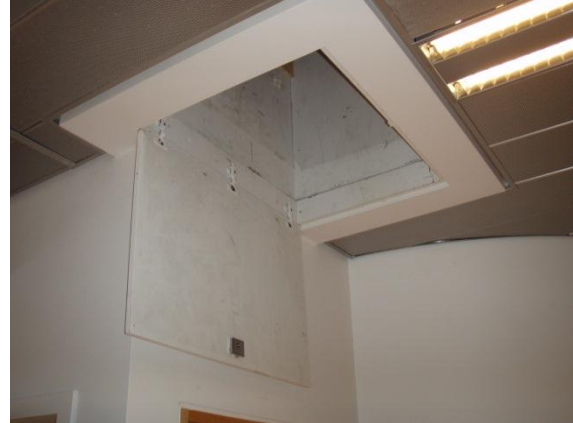
Mynd nr. 1. Lúga fyrir mannopi upp í þakrymi læsist ekki. Loka þarf lúgunni. (1)
