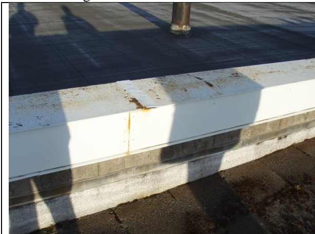
Mynd nr. 1. Steiptur veggur sem gengur upp úr þaki stöðvarinnar er klæddur með blikk áfelli sem er byrjuð að ryðga. Mála þarf áfelluna. (2)*
