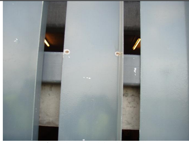
Mynd nr. 4. Ryð er byrjað að myndast á málmklæðningu á norðurhlið bílageymslunnar. Einkum út frá suðum og víða. Mála þarf klæðninguna innan tíðar. (3)
