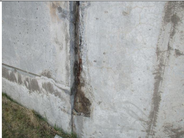
Mynd nr. 5. Stór múrskemmd er í suðausturhorni bílgeymslunnar. Gera þarf við þessa skemmd og ganga frá steypuskilum með áláfelli yfir. (1)
