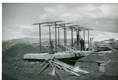
Mynd 19: Þjónustustöð Shell við Miklubraut í byggingu. Hér sjást einfaldar uppistöður húsanna úr stáli vel.
