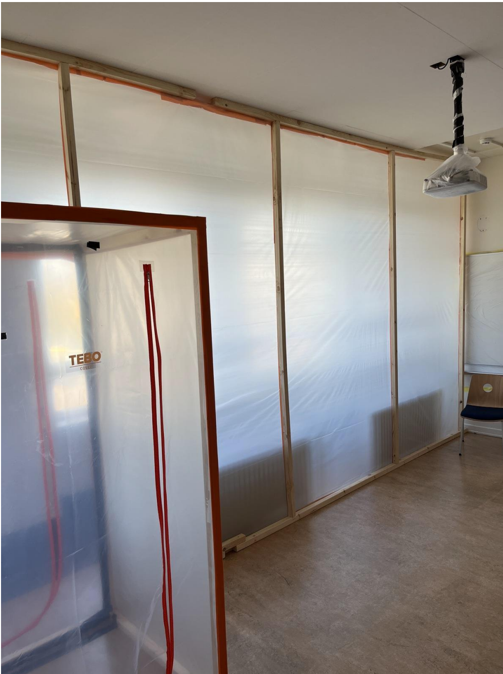
Svæði sem unnið var á plastað með fordyri til að minnka ryksöfnun inn í stofu. Laugarnesskóli 2023
