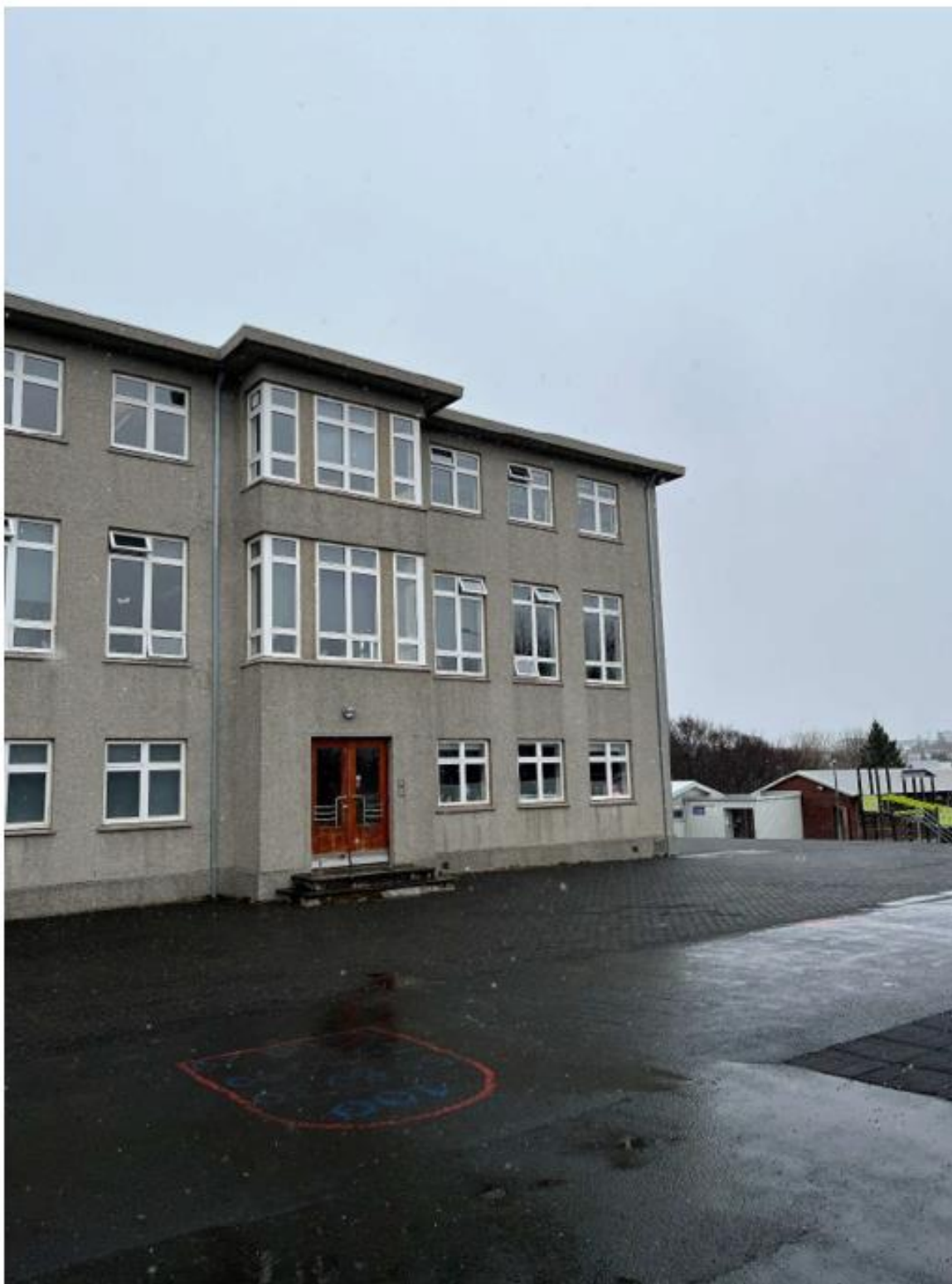
Mynd 61. Hlið stjórnendaálmú, Fyllrost efni borið í kringum glugga til að koma í veg fyrir leka
