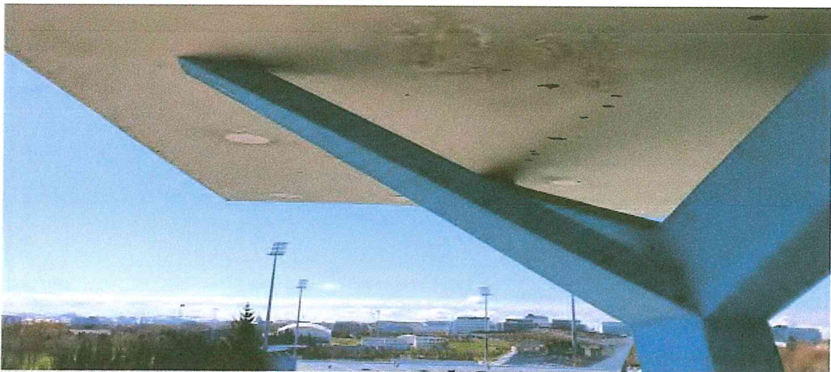
Mynd 15. Skemmdir í stoðum undir skyggni, staðbundin ryðmyndun í lykkjum, sprungur í steypu. Einnig sjást merki um rakaf læði í gegnum plötu skyggnis.
