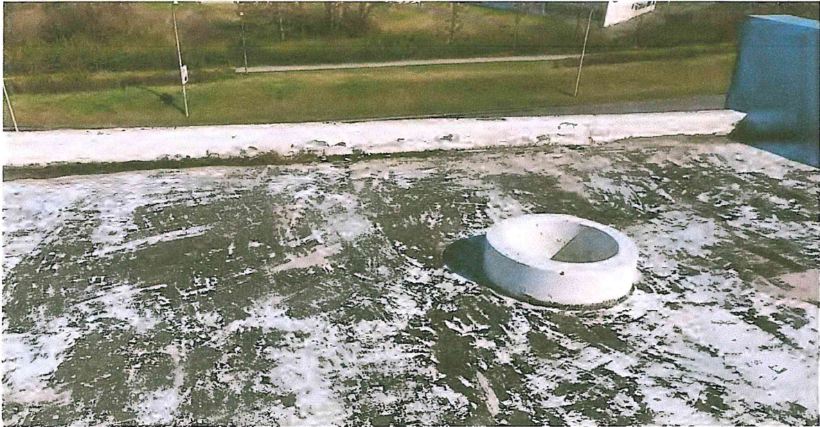
Mynd 5. Horft vestur eftir þaki. Í steyptri þakrennu við vestur brún þaksins eru skemmdir vegna vatns.
