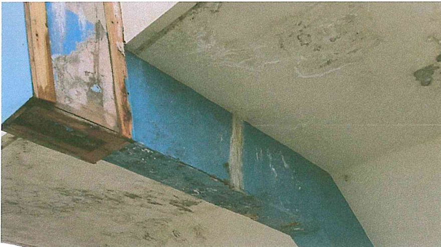
Mynd 8. Skemmdir á steypum ramma við vesturvegg (undir plötu áhorfendasvæðis). Þegar klæðningu er flett af kom í ljós steypuviðgerðir og merki um að bleyta hafi komist inn fyrir klæðningu.
