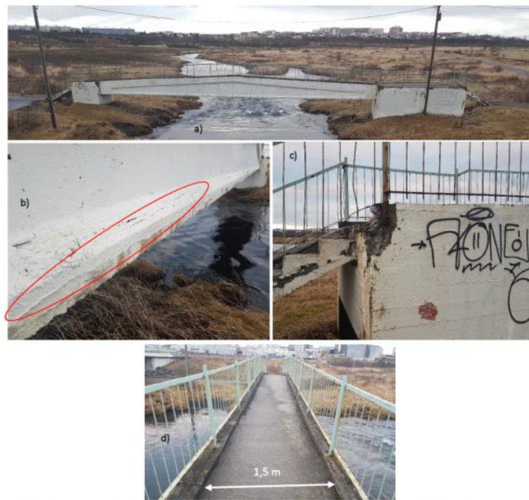
Mynd 5: Núverandi göngubrú, a) hliðarmynd, b) sprungur í neðri flangi burðarbita, c) illa farið steypuvirki stöpla, d) þversnið
