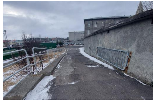
Mynd 3.4. Ástand yfirborðs er orðið lélegt
