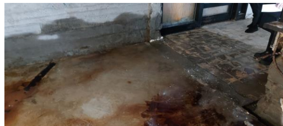
Mynd 5-12: Leki í gegnum þakplötu.
