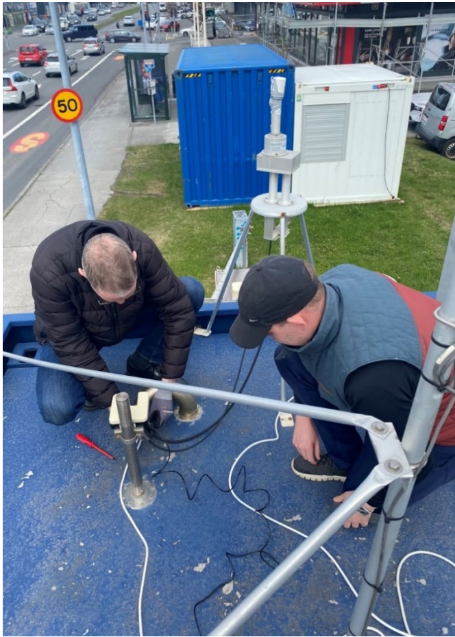
Uppsetning á loftgæðamæli við Grensásveg
